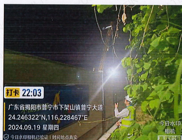
玉丰村 (下架山泵站) 西侧外 1m2#
